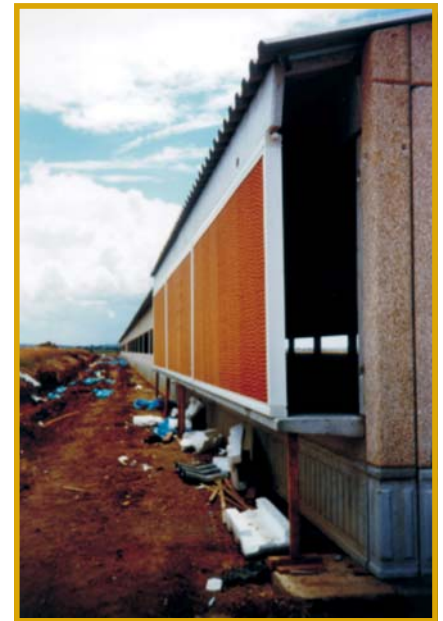
Fig. 5. Paneles de refrigeración montados en un gallinero.
