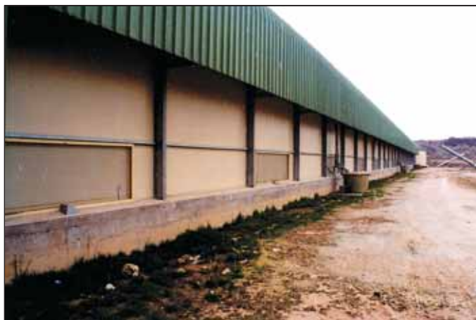
Las trampillas de emergencia en la parte baja de las fachadas de una granja de puesta son una inversión necesaria para casos de fallos de corriente.
