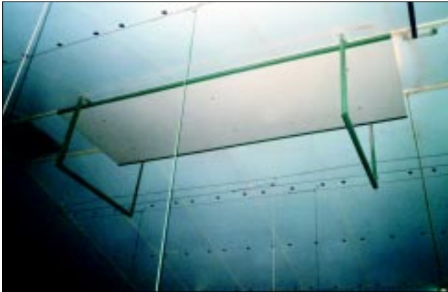
Trampilla situada en el techo de la nave para sustituir a los ventiladores, junto con las trampillas de las paredes laterales, en caso de fallo eléctrico.
