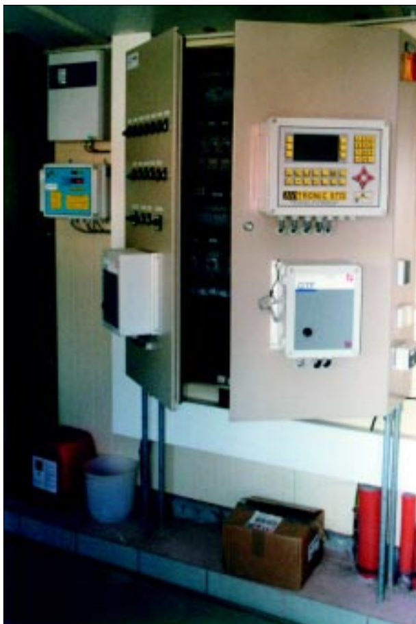
Ordenador y panel de control medioambiental electrónico, situado en el almacén de la granja y cuyas prestaciones son de lo más sofisticadas.
