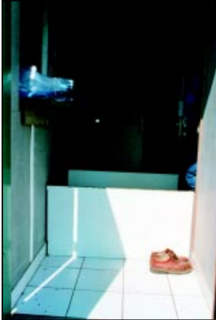
Pequeño departamento situado justo a la entrada de la nave, lugar de paso obligatorio para el cambio de calzado y el lavado de manos.
